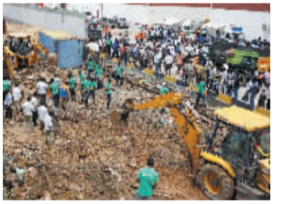
7月6日,工作人员在清理事故现场。
