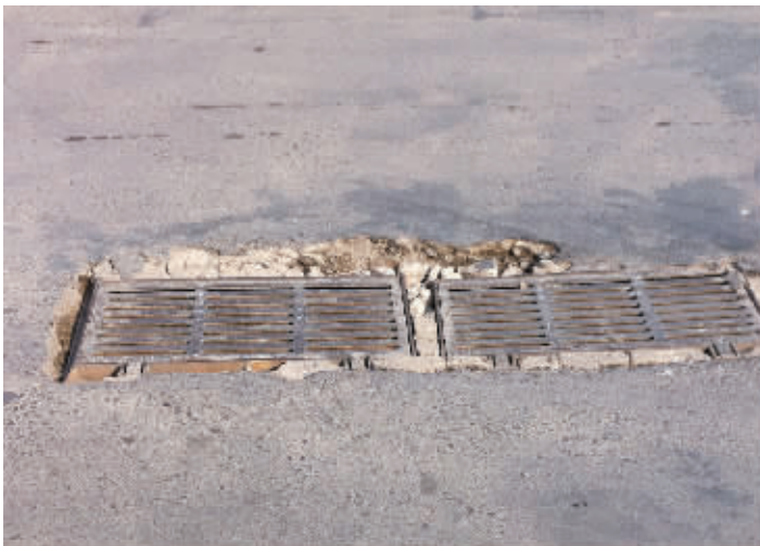
路面上破损和下陷的井盖 胡四荣 摄
